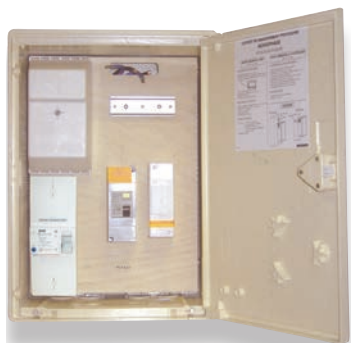
Coffret de branchement provisoire monophasé (P490 - P489)
