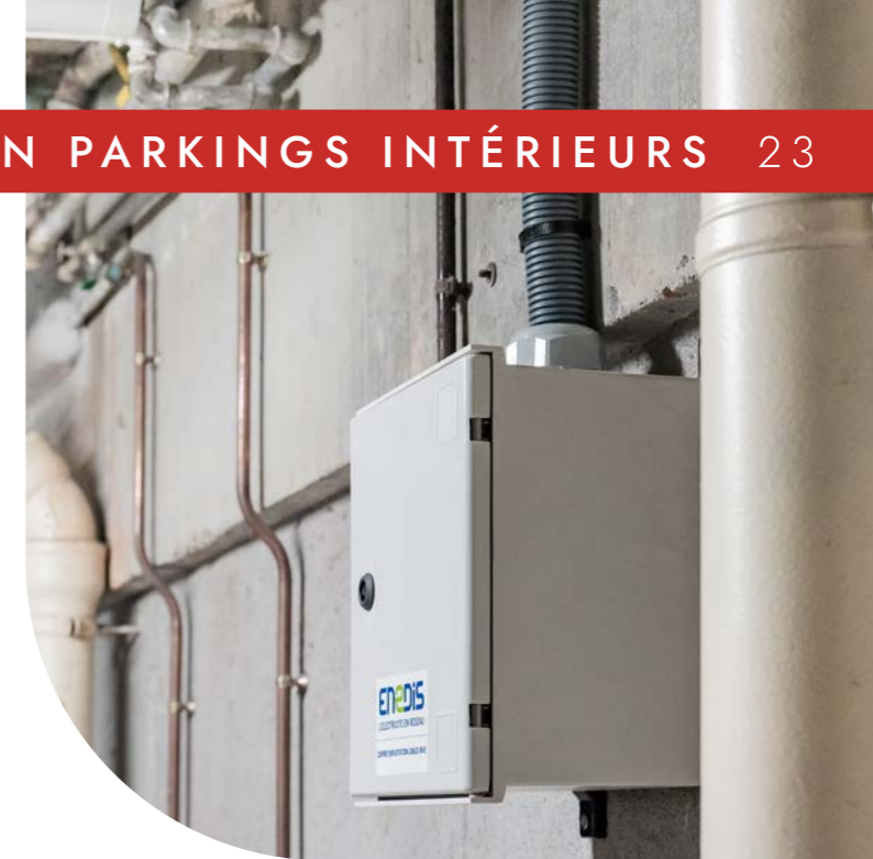
Exemple de coffret d'exploitation
