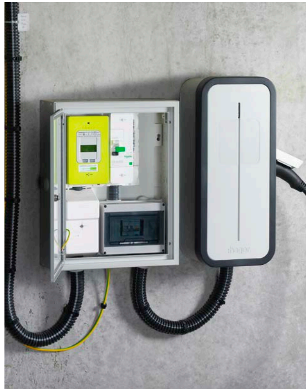
Exemple d'armoire de comptage associée à une borne de recharge
